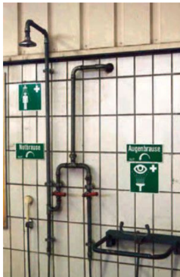
Abbildung 5: Zu einer Batterieladestation gehört eine Notdusche und eine Augenspülstation (Augenbrause)
